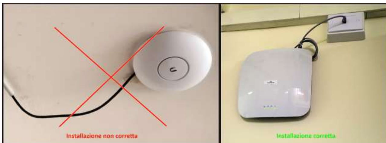
Figura 10 – Installazione corretta dell'Access Point
